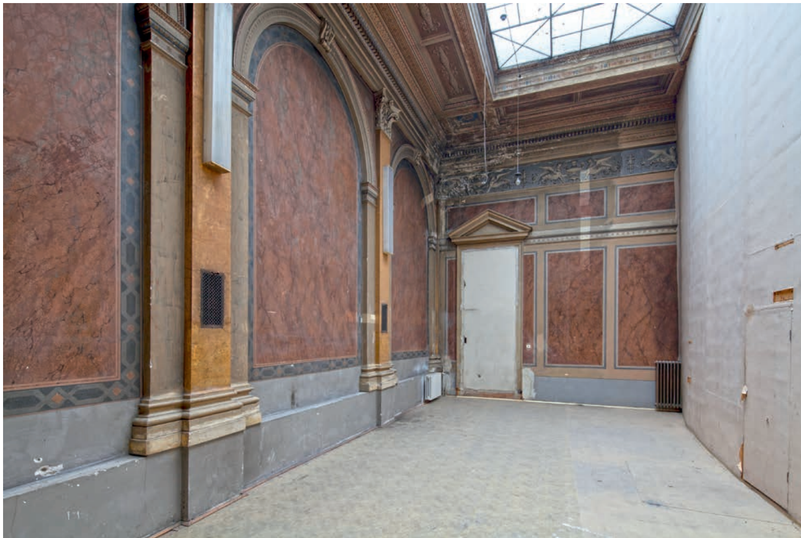
Západní galerie nebyla z důvodu havarijního stavu využívána
