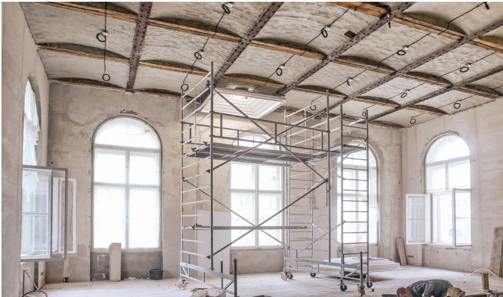
Při rekonstrukci byly opraveny omítky a odstraněn nesoudržný stropní podhled Snímek byl pořízen po instalaci prototypu jedné stropní kazety s osvětlením
