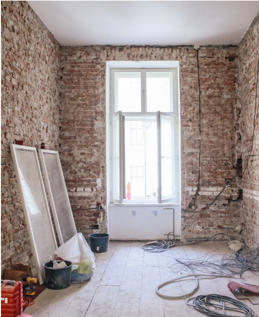
Vstupní prostor pro návštěvy – snímek pořízen v době rekonstrukce Kompletně byly odstraněny nesoudržné omítky a nášlapná vrstva podlahy
